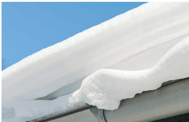
Auch Schneedruck auf dem Dach kann zu schweren Schäden führen.
